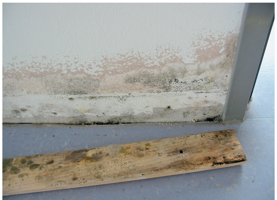
Abb. 1: Das sichtbare Schadensbild lässt auf einen Wasserschaden mit verdeckten Schimmelschäden am Wandfuß und in der benachbarten Fußbodenkonstruktion schließen
