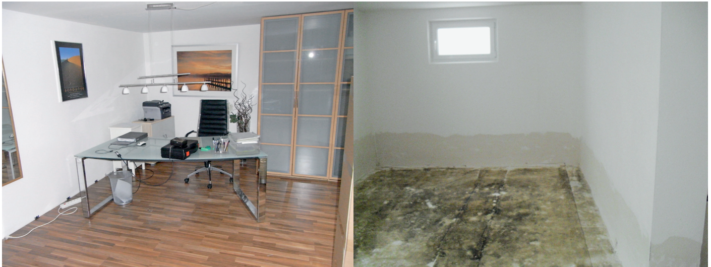
Abb. 2 und 3: Wohnung vor Erkennen des Schimmelschadens und nach der Schadensbeseitigung
