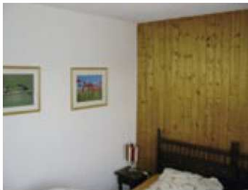
Abb. 3: Mit Holzschutzmittelwirkstoffen belastete Wandverbreterung
