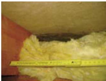
Abb. 2: Nicht sichtbarer Schimmelpilzbefall in Mineralwolle
