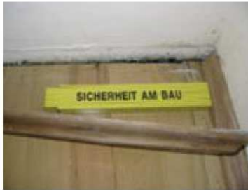
Abb. 1: Versteckter Schimmelpilzbefall hinter einer Fußbodenrandleiste und unter dem Fußboden
